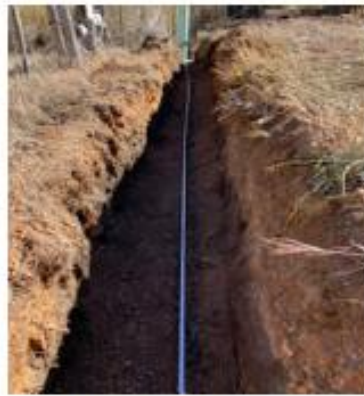
Electrical conduit to solar mast
